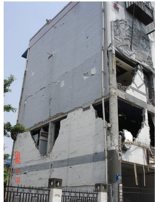
(d) Partial failure of longitudinal and transverse infill walls
