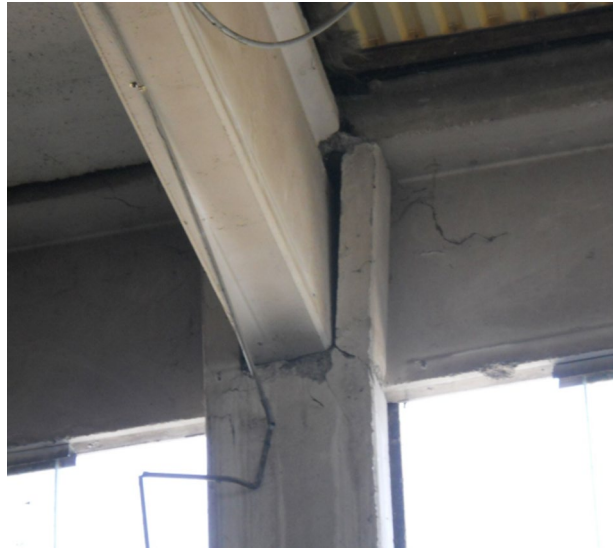
Fig. 3 Example of damage patterns P3–P4. Image source: Agenzia Regionale per la Ricostruzione—Sisma (2012)
