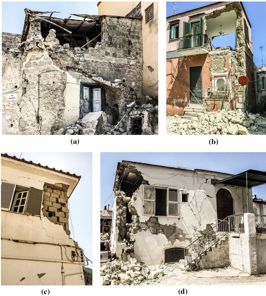
Fig. 24 Damage at building corners: a via Montecito (Lat: 40.742–Lon: 13.8995); b viale Ottringolo (Lat: 40.7428–Lon: 13.9023); c via D’Aloisio (Lat: 40.7434–Lon: 13.8976); d via Montecito (Lat: 40.7419–Lon: 13.8995)
