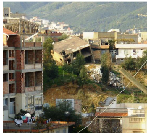
Fig. 20 Basculement d'une construction récente
