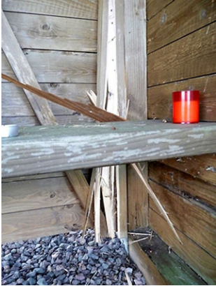
Abb. 3 ◀ Mechanische Zerstörungen im Innenbereich einer Holzhütte auf einem Golfplatz bei einem Blitzunfall mit 4 Todesopfern. (Mit freundl. Genehmigung von Herrn T. Raphael, Ausschuss für Blitzschutz und Blitzforschung des Verbandes der Elektrotechnik, Elektronik und Informationstechnik e. V., Frankfurt a. M.) [2]
