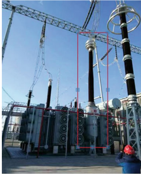
Fig. 2 Actual arrangement of UHV bushing
