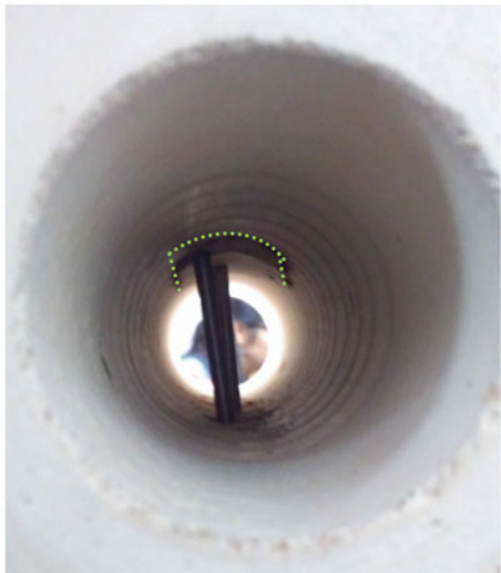
(d) Cracked Surface Inside Tunnel
