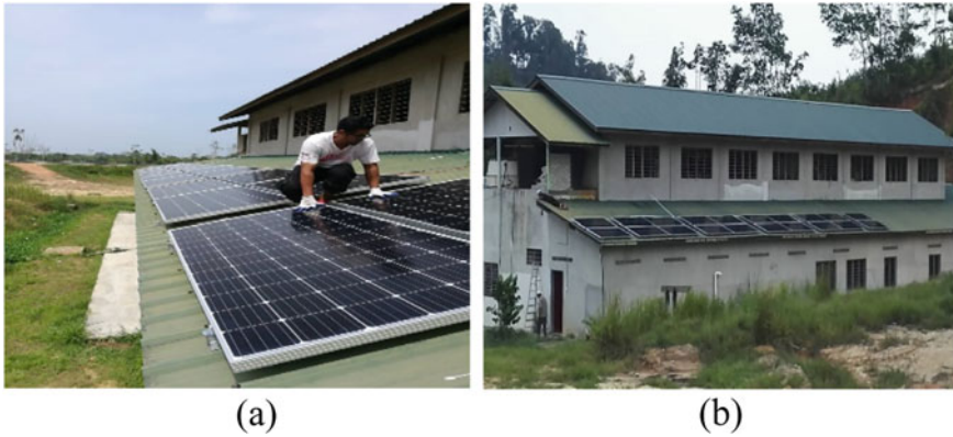
Fig. 2 Solar PV setup
