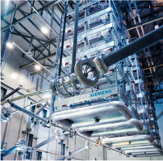
Fig. 12.47 500 kV thyristor valves (© Siemens)
