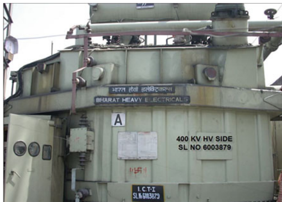
Fig. 6 400 kV HV side view
