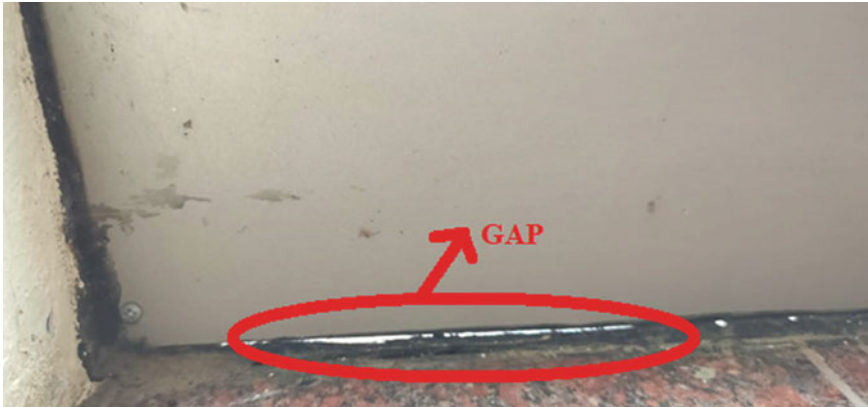
Fig. 11 Façade spandrel gap
