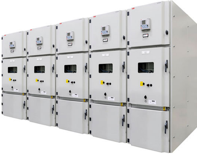
Fig. 6.7 MV Switch gear
