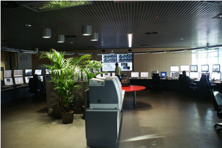
Fig. 2.6 Control room at BP Gelsenkirchen/Ruhr Oel GmbH (Photo courtesy of BP Gelsenkirchen/Ruhr Oel GmbH)
