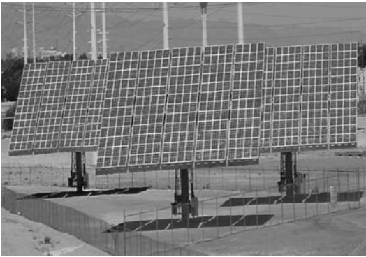
Fig. 12.25. Nevada Power site
