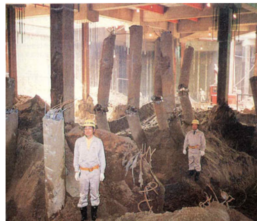
Fig. 17.25 Broken piles in Niigata (Kawamura et al. 1985)
