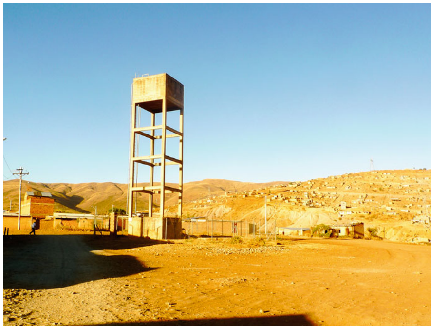
Fig. 9.2 Agua Sur water tank
