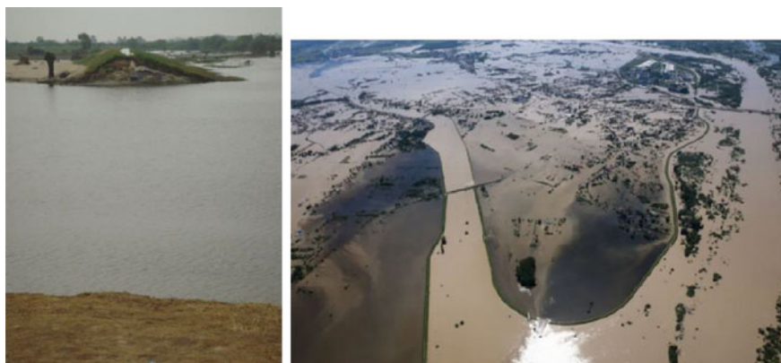
Fig. 5 Sandomierz region—the effect of levee failure in May and June of 2010. Source: Koncepcja ochrony przed powodzią Wisły i jej dopływów w rejonie Sandomierza i Tarnobrzega – Projekt Studialny (2009)
