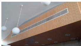
(d) Air duct above main desk
