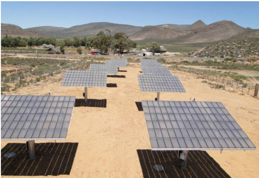
Fig. 21 Touwsrivier HCPV power plant ( courtesy of Soitec)
