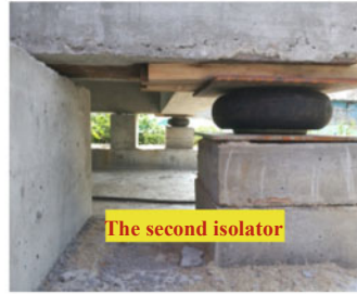
(d) The installed geosynthetic isolator.
