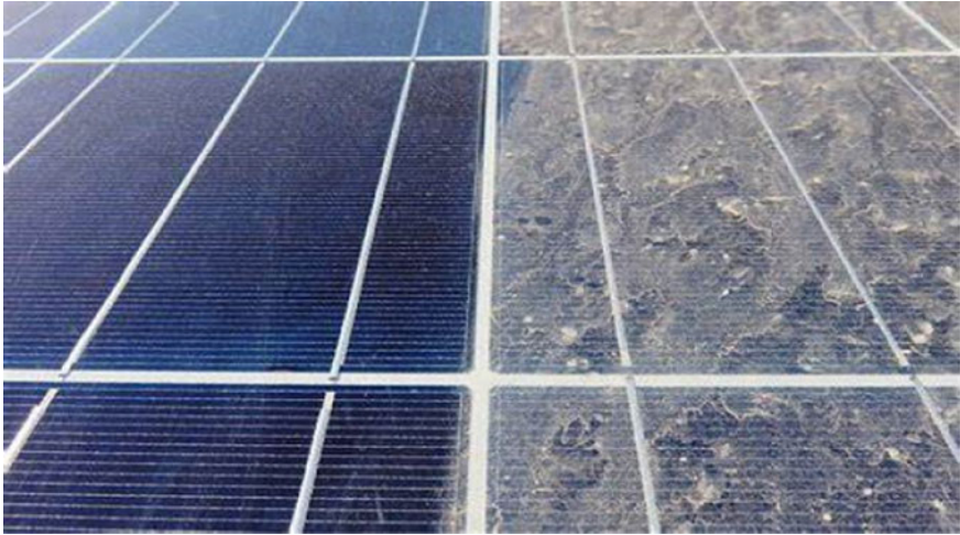
Fig. 1 Soiling of solar PV module
