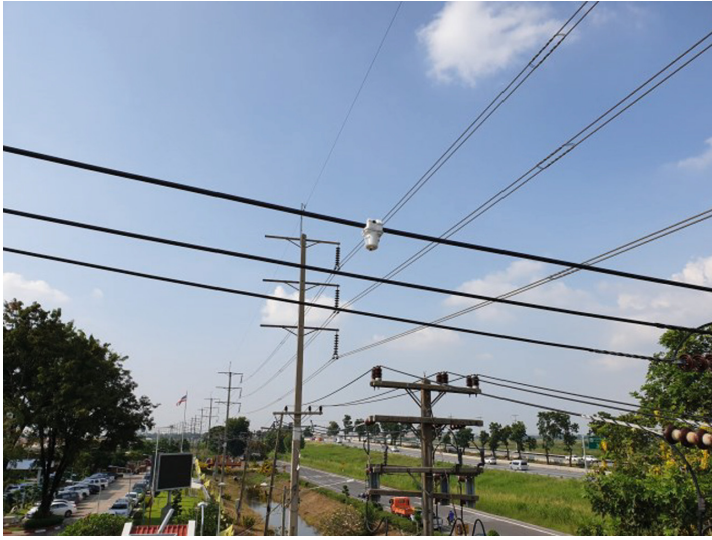
Fig. 11. The overview of actual installation
