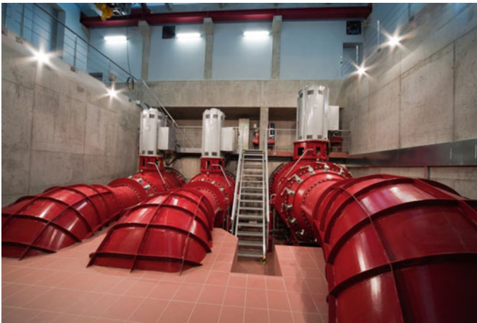
Fig. 15.32 Machine room of the SHPP Železný Brod powerhouse (source Vodní elektrárna Železný Brod, a.s.)
