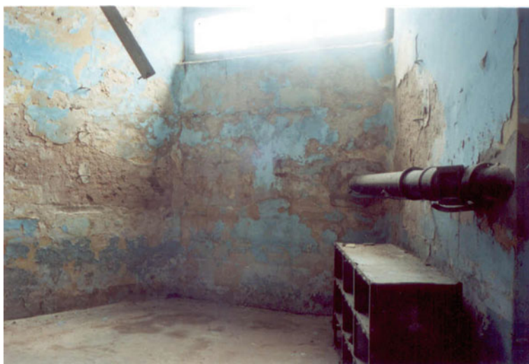
Fig. 13.9 The “men’s room” in the basement. Courtesy of the Equipo de Investigación por la Memoria Político Cultural (E.I.Me.Po.C.) photographic archive
